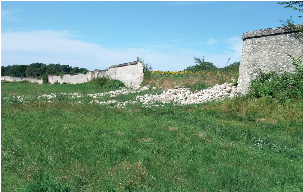
Effondrement du mur d'enceinte à réparer.
